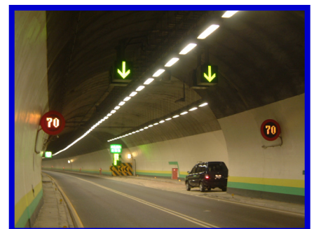
車道管制號誌、速限可變標誌
